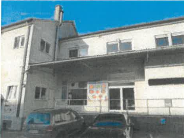
Abb. 3: Längsseitiger Dachüberstand ohne Auflageflächen zum Nestbau und ohne Spalten.
