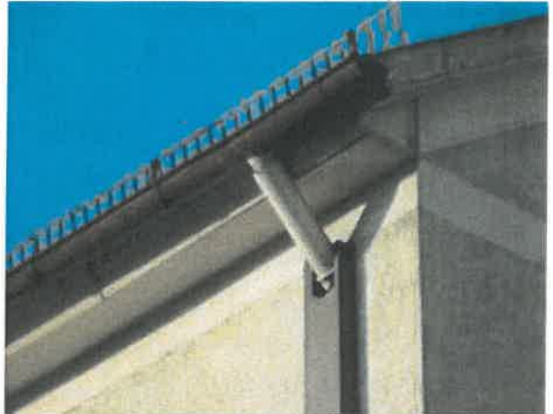
Abb. 2: Längsseitiger Dachüberstand ohne Auflageflächen zum Nestbau und ohne Spalten.
