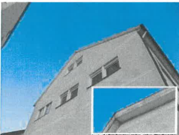
Abb. 5: Querseitiger Dachabschluss ohne Auflageflächen zum Nestbau und ohne Spalten.
